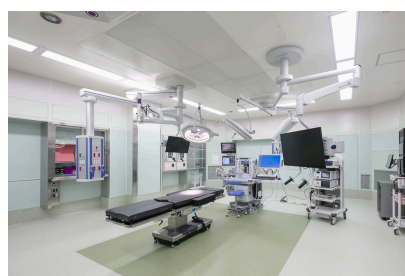
人工関節置換術を行うバイオクリーンルーム
